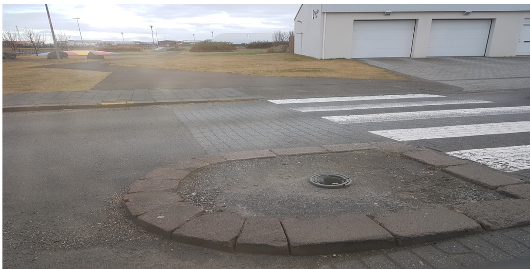
Mynd 19. umferðarskilti farið og ekki lagfært og illa upplýst gangbraut.
